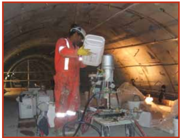
Construction de tunnels, coulis chimique, Edmonton, Alberta Le coulis chimique est utilisé pour stabiliser le sol, couper le débit d'eau actif et sceller les joints qui fuient dans diverses formes de construction de tunnels.
